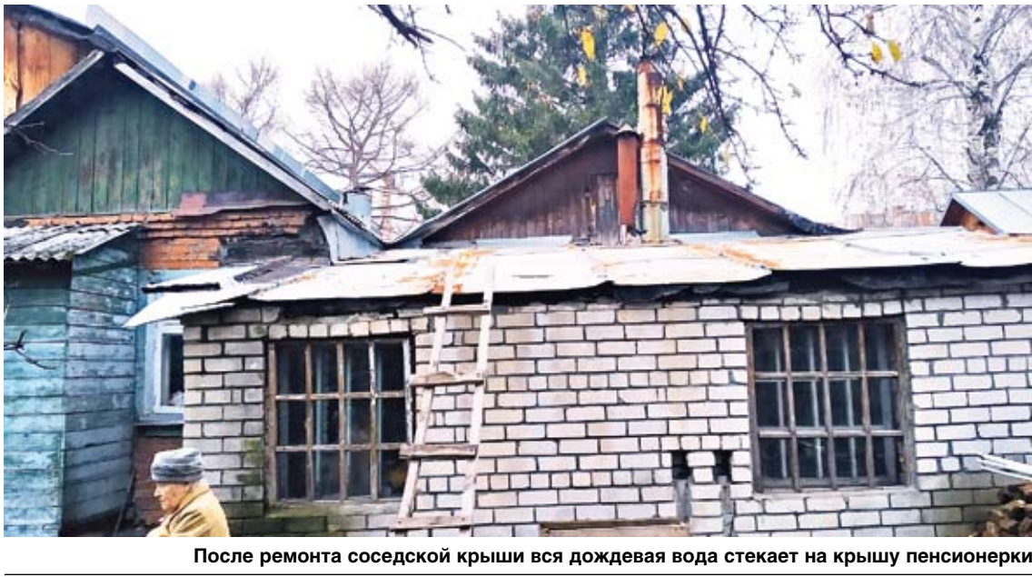
После ремонта соседской крыши вся дождевая вода стекает на крышу пенсионерки
