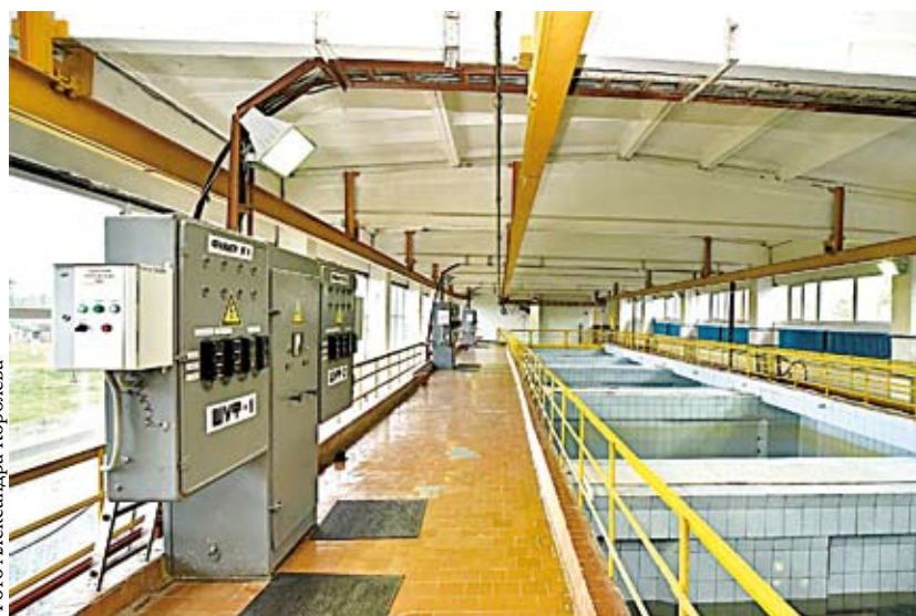
Цех очистки воды
