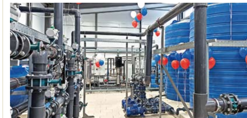
Новый водозаборный узел в Спас-Клепиках работает в полностью автоматизированном режиме
