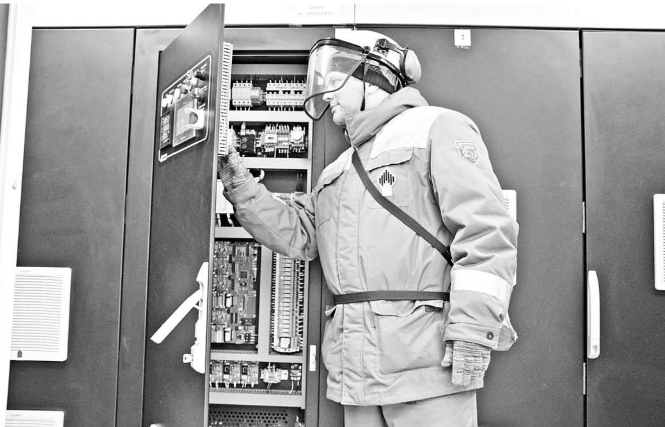
Мастер участка №11 по эксплуатации электрооборудования Роман Слепов осматривает электрооборудование системы
